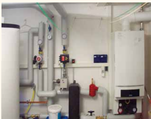
Objekt: Rembrandtweg 1/3/5 und 7/9/11 Heizanlage mit zentraler Warmwasserversorgung
